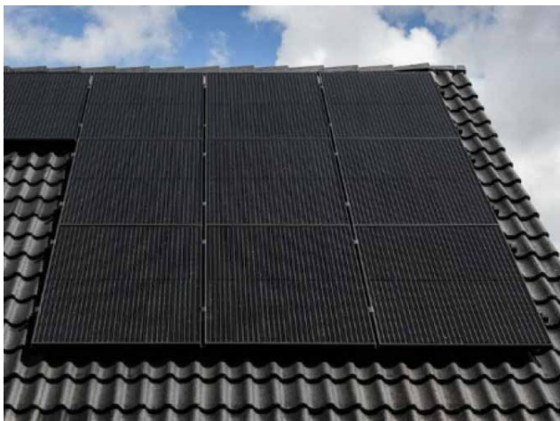
PV panelen op-daks-systeem, aantal panelen volgens Beng berekening.
